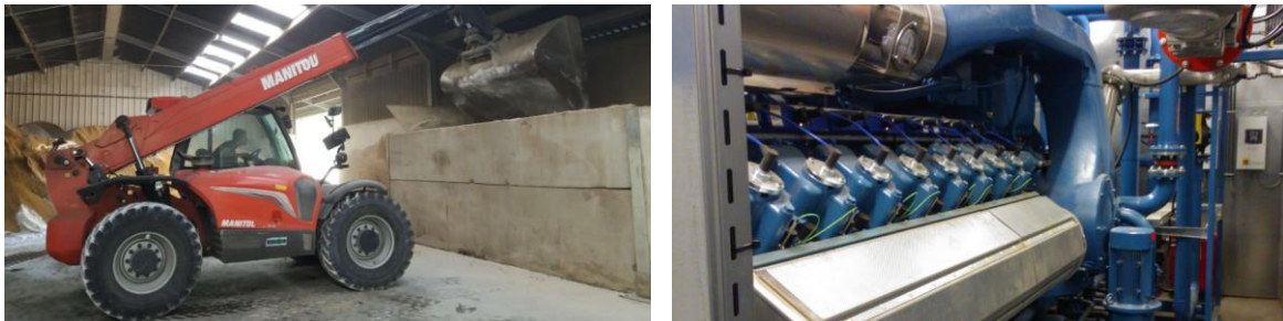
Figuur 47. De activiteiten en biogasinstallatie bij Agro-Energiek
